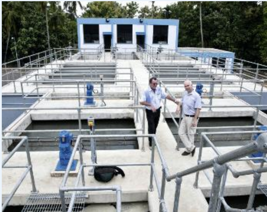
Don Huntriss en Willem Kroonen op de nieuwe waterzuiveringsinstallatie.
