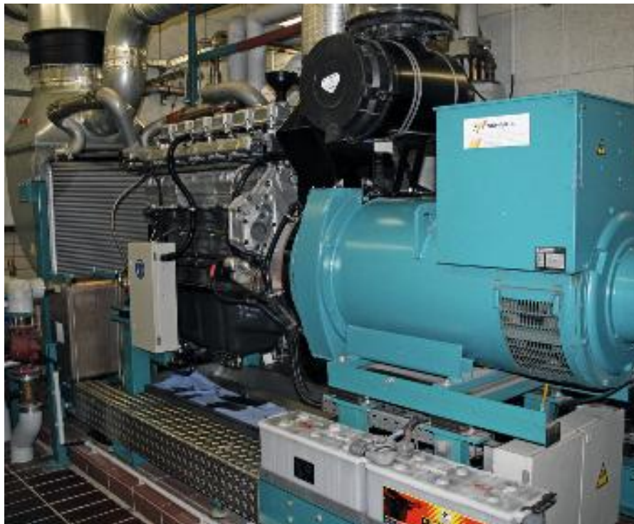
De warmtekrachtkoppelinginstallatie in Kampen.
