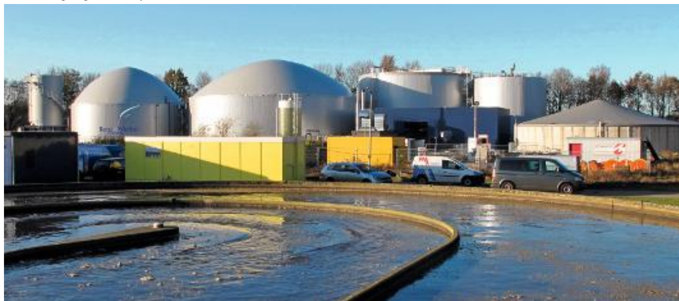
De nieuwe slijbgistingsinstallatie op de rwzi in Echten.
