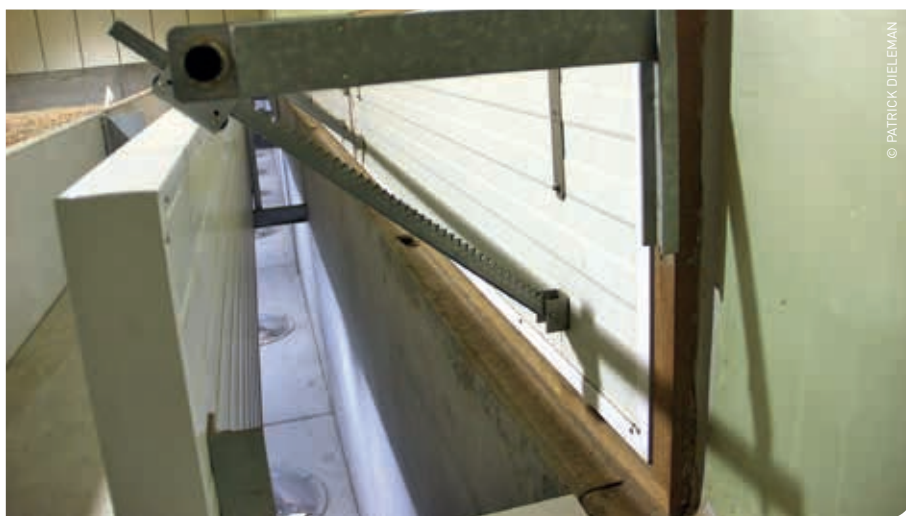
De menglucht wordt gemaakt in de ruimte tussen het ventilatorplafond en het kleppenplafond. Naarmate de luchtinlaatklep meer wordt geopend stijgt het aandeel verse buitenlucht.
