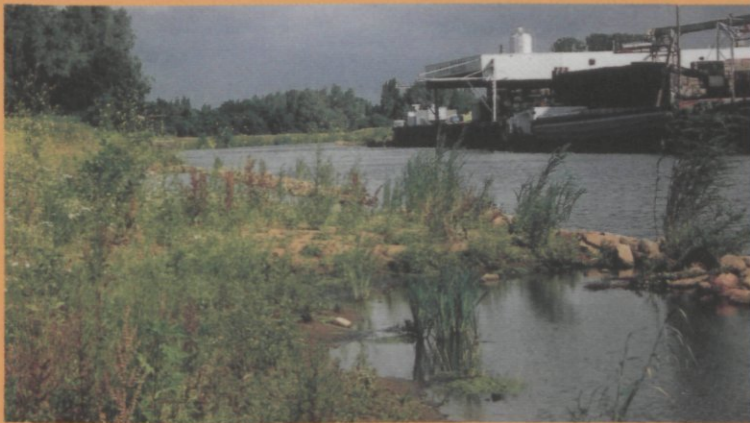
Een stortstenen voor-oever beschermt een natuurvriendelijke oever bij een industrieterrein in Doetinchem in de evz Oude IJssel.
