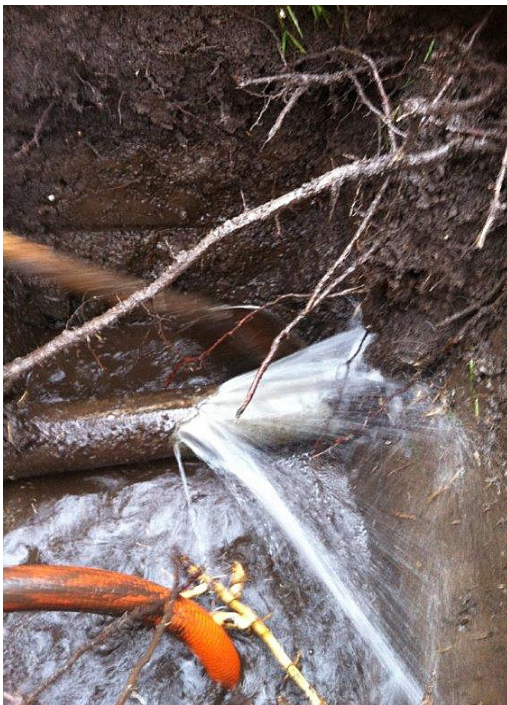
Afbeelding 3. Dankzij DMA opgespoorde lekkage in leiding Reeuwijk
