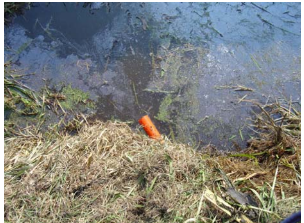
Afwerking van de drainage in de sloot. Het is duidelijk te zien dat de onderwaterdrains diagonaal door het perceel lopen.
