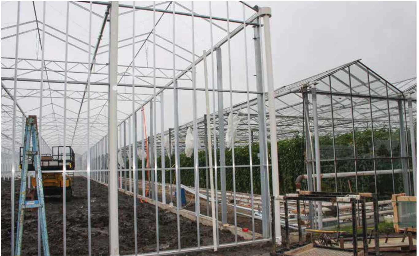
Om de oudere glastuinbouwgebieden te herstructureren en te verduurzamen is het project 'Moderne Tuinbouw' gestart.
