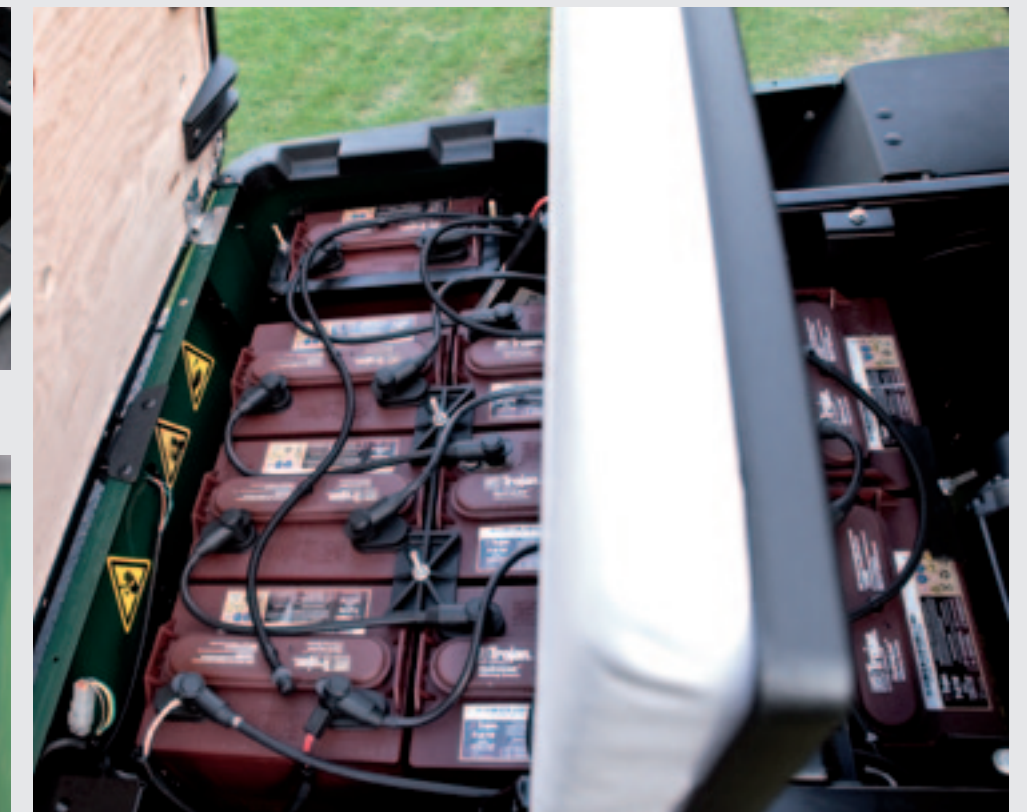
Onder de bank en onder de laadbak zitten negen loodzuuraccu's van elk 8 volt, goed voor 72 volt. Het pakket heeft een centraal systeem om de afzonderlijke accu's met water af te vullen.
