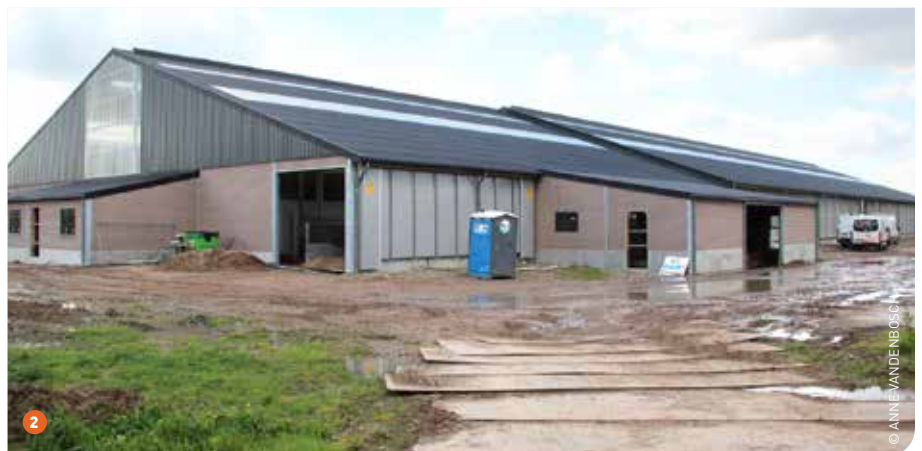
1 De 7 bindplaatsen hebben ieder een meter voor het drinkwaterverbruik. 2 De stal in de fase van afwerking.
