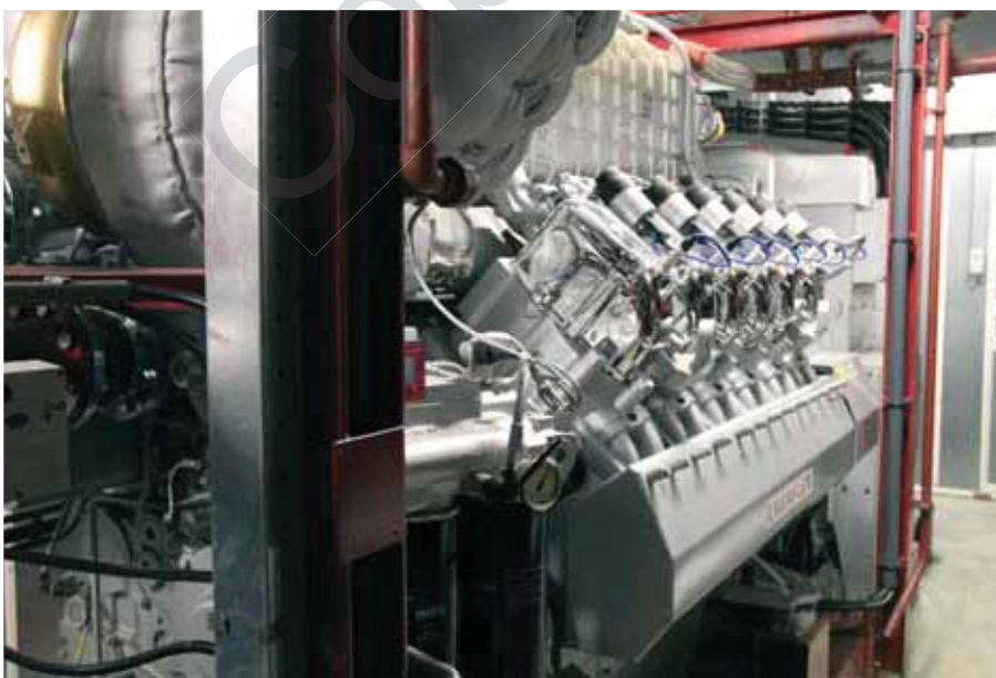
▲ De Enerflex-WKK met MTU-gasmotor heeft een rendement van 105% waardoor de stookkosten konden teruggebracht worden van 15 naar 5 euro per m 2 .
