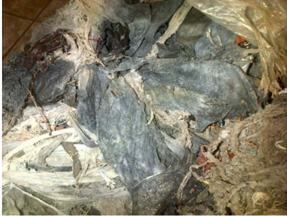
Figuur 1.5. Doeken die uit het pomphuis van één van de pompen zijn verwijderd.
