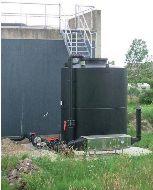
Figuur 5.1. Lavafilter rioolgemaal Zegge.
