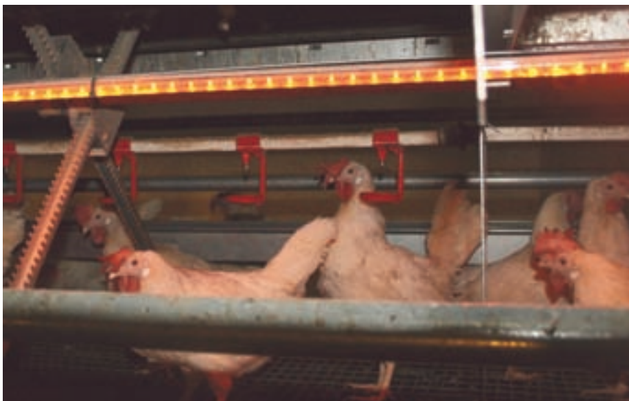
In het systeem zijn led-buizen gemonteerd die volledig dimbaar zijn.
