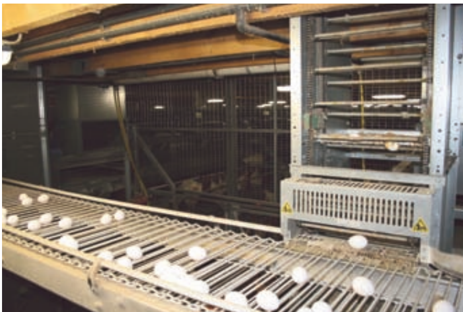
Via elevatoren worden de eieren van beide etages naar de centrale transportband aan de voorzijde van de stal getransporteerd.
