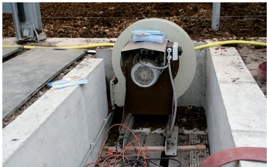
Twee ventilatoren blazen lucht door het buizensysteem.
