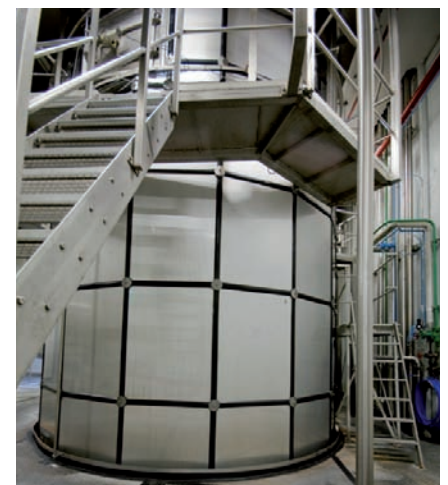
Een sproeidroogkamer voorzien van een nieuwe isolatiemantel.
