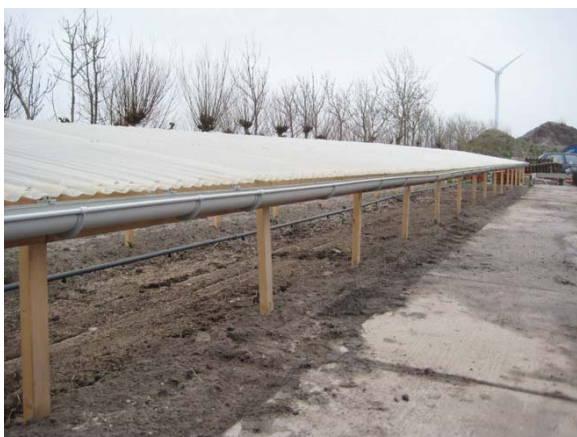
◀ Fytobak in de grond met behulp van vijverfolie bij loonbedrijf Hoogland in Burgervlotbrug.
