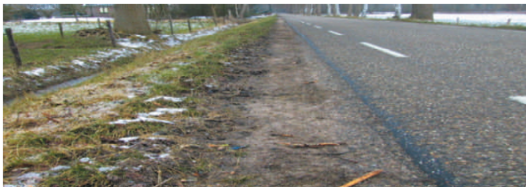
Berm schade langs de Rhienderensestraat.
