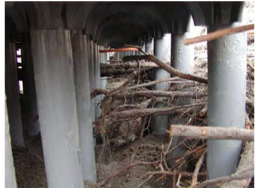
Figuur: 9.3 wortels in de watershells zijn niet wenselijk Bron: Totaal-documentatiemap.waterblock BV
