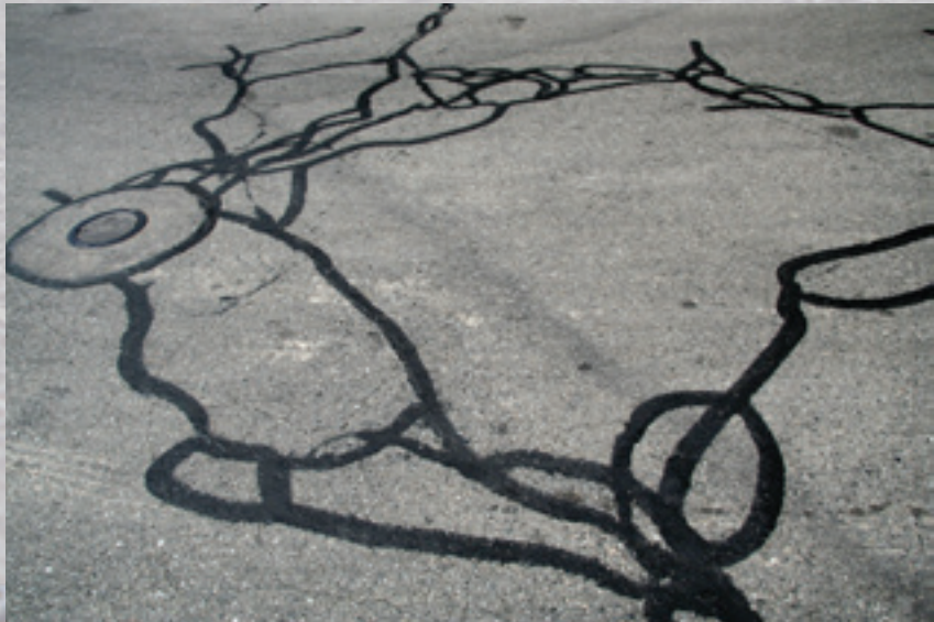
fig. 2.13 - Scheuren zijn met bitumen weer aan elkaar gelijmd
