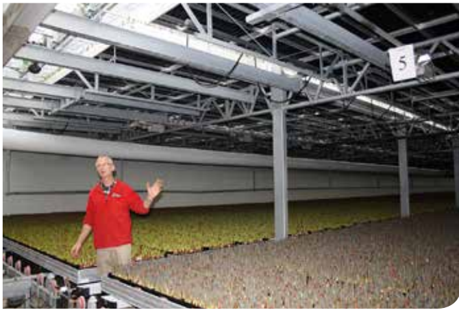
▲ In de serre met twee teeltlagen werden onderaan luchtslangen, heaters en SON-T belichting opgehangen
