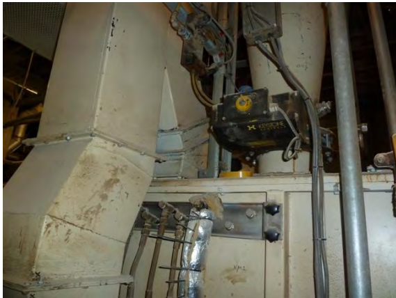
Afbeelding 12 Ontluchting van de menger en onderbunker met daarnaast de cycloon (zie 4.2.7.1) van het Closed loop systeem van de bijstort.
