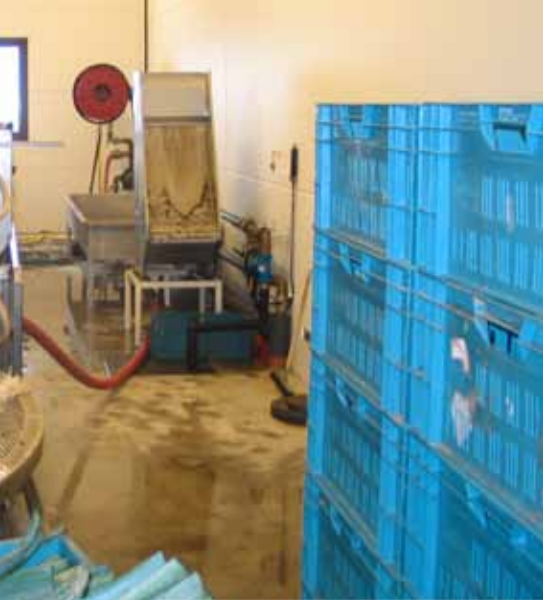
De preiwaswaterinstallatie op het POVLt, met uiterst rechts de zeefbocht.
