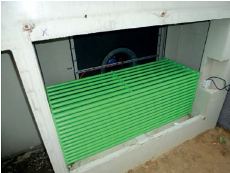
Figuur 3. Geopende LBU met een deel van de lucht/lucht-warmtewisselaar en op de achtergrond de ventilator voor de aanzuiging van buitenlucht.
