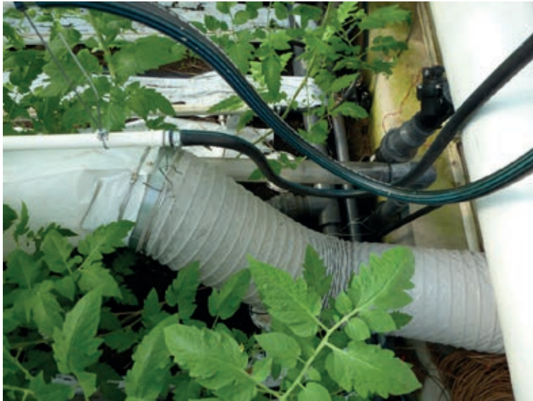
Figuur 5. Aansluiting van de luchtslurven op de LBU met flexibele slang.
