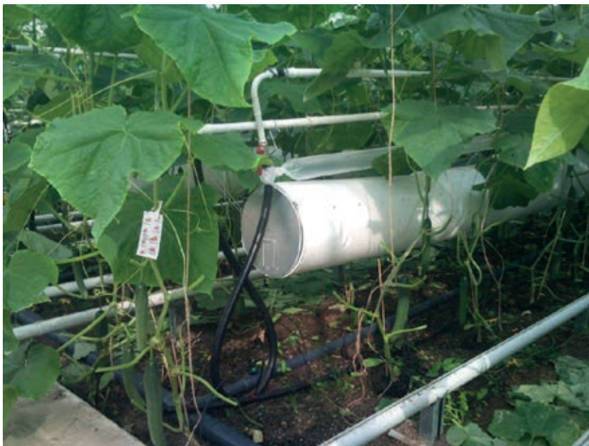
Figuur 1. Luchtslurf tussen het komkommersgewas, daarboven een aparte CO 2 -darm en een dubbele groeibuis.
