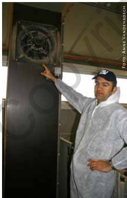
Luc Van Lierop toont de mengventilator die ondergronds warme stallucht mengt bij de inkomende buitenlucht.
