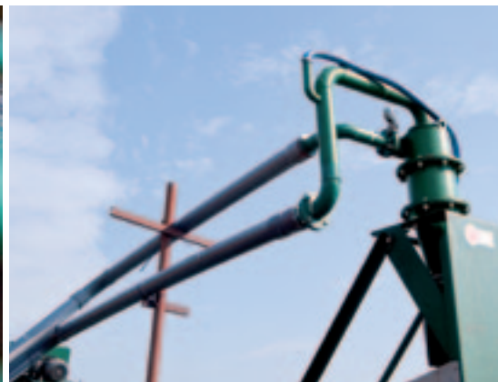
De van zand gescheiden mest gaat via de cycloon, die het laatste zand uit de mest haalt, naar de tweede put en dan naar de scheider.
