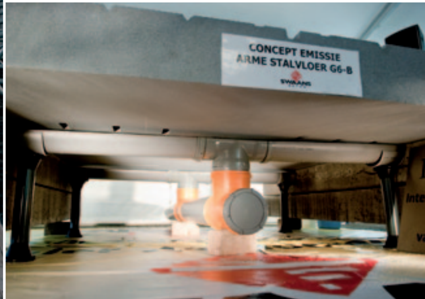
Gescheiden afvoeren van de dikke mest en urine staat in de belangstelling. Een concept van Swaans Beton is om urine via een riool af te voeren.
