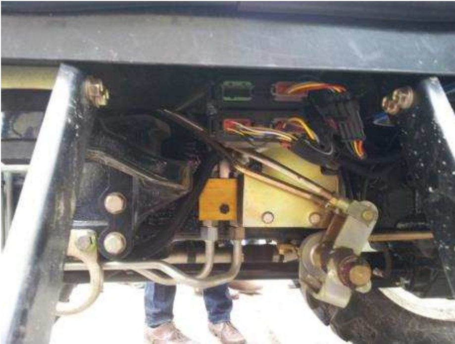
Figuur 8. De Inertial Measurement Unit en de Tractor Control Module onder de linker treeplank.
