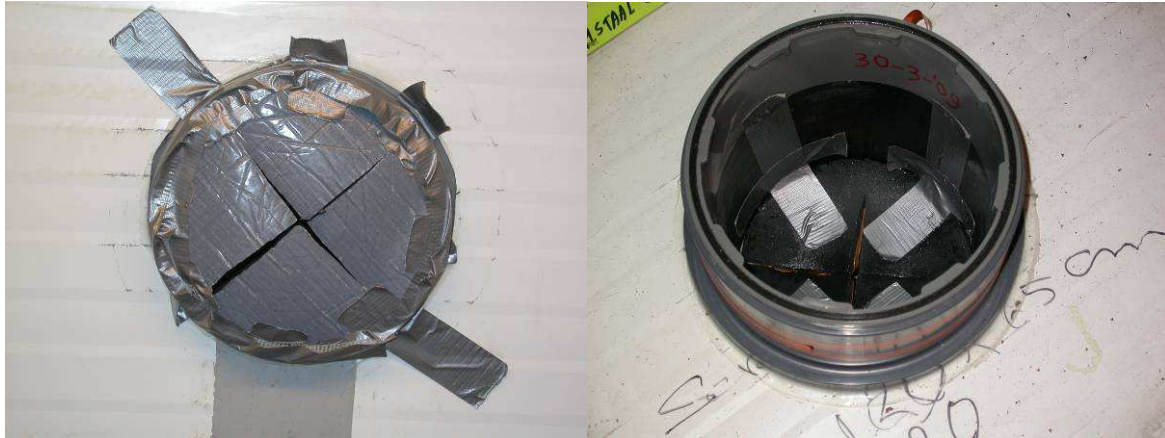
Foto 1: Meetbuis in plafond; isolatiemateriaal bevestigd in de buis (links), bovenaanzicht (rechts).
