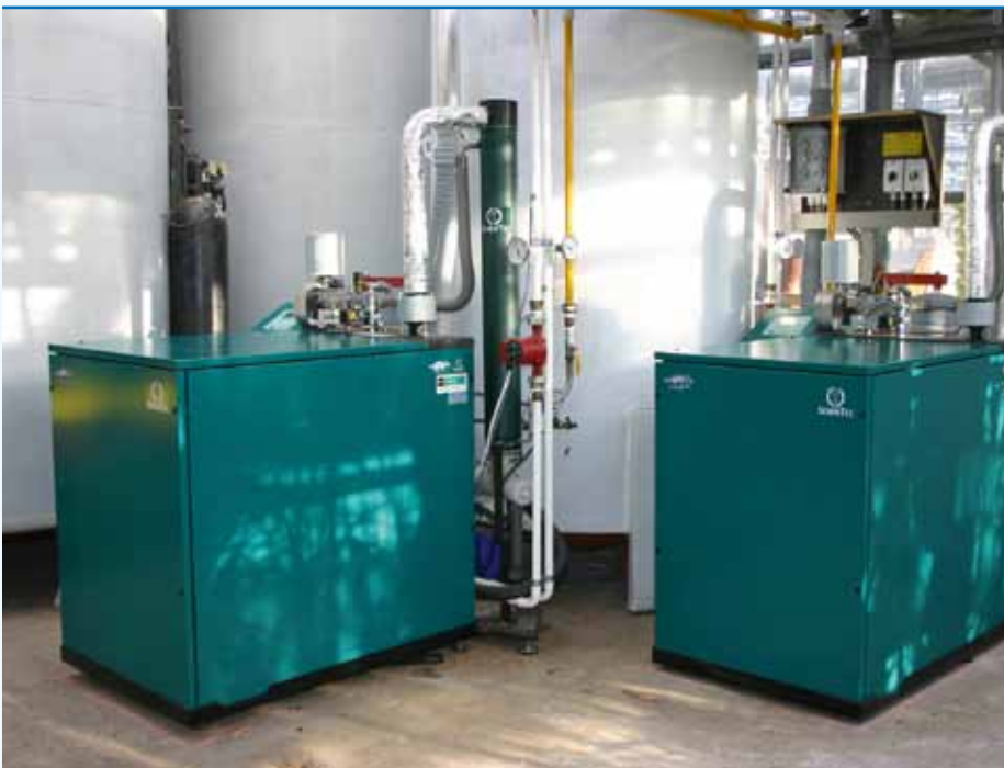
Met twee mini WKK’s is het bedrijf zelfvoorzienend in het elektriciteitsverbruik en verlaagt daarmee de energiekosten.
