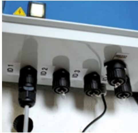
De besturingskast heeft vier aansluitingen voor antennes en selectiepoorten.
