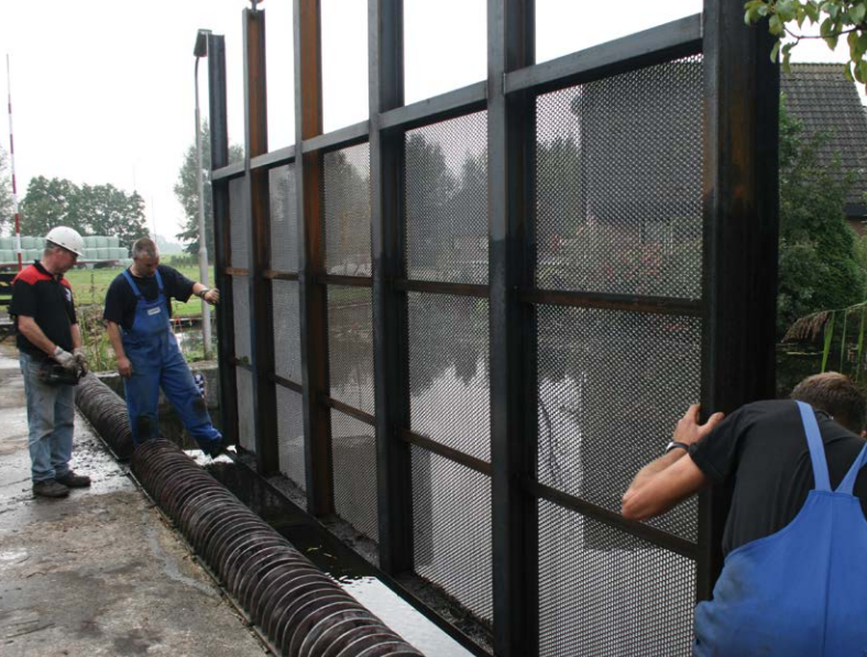
Fijnroosters kunnen goed werken mitst ze regelmatig worden schoongemaakt en juist worden geplaatst.
