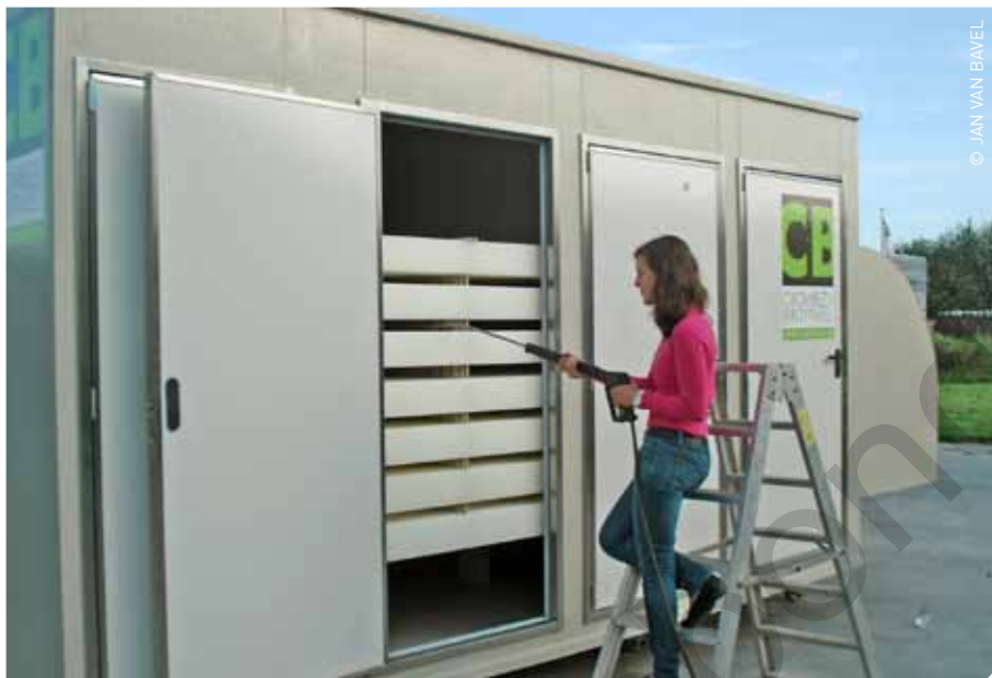
De warmtewisselaar is erg onderhoudsvriendelijk. Met een hogedrukpuit kan je de vuile lamellen prima reinigen.
