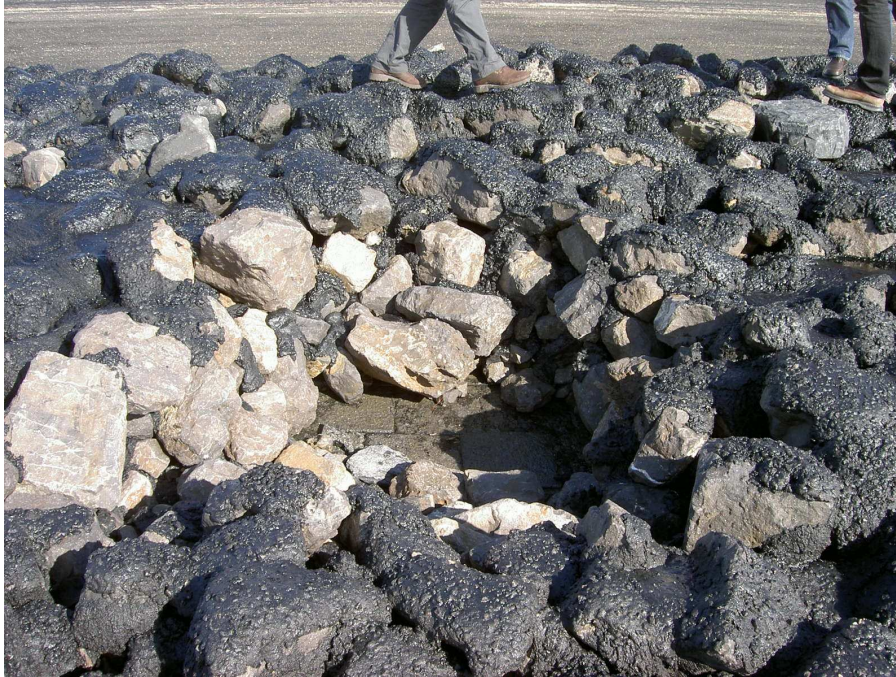
Figuur: Voorbeeld van gat in gepenetreerde breuksteenbekleding. De onderlaag, een oude steenzetting, is zichtbaar.
