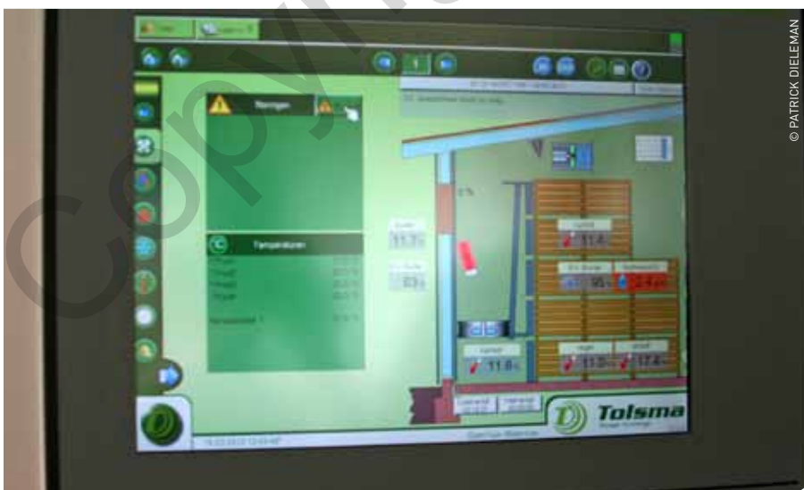
De display van de klimaatcomputer bevindt zich in de doorgang naar de controlegang. Dit is niet de meest sexy plaats, maar wel de effectiefste.
