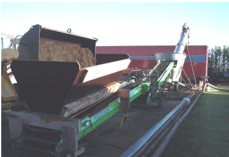
Figuur 7 Installatie voor hygiënisatie van dikke fractie door middel van een vizel met stoominjectie die lost in een oplegger (Foto Livestock Research).
