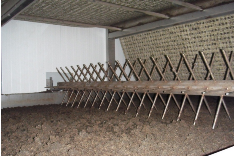
Foto 3: Binnenzijde van platendroger voor dikke fractie digestaat van covergisting waarbij gebruik gemaakt wordt van teruggewonnen restwarmte van de WKK (foto: Livestock Research)
