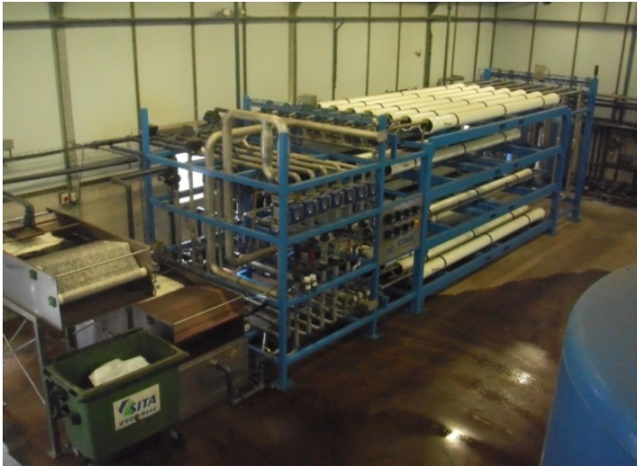
Foto 4: Productie van mineralenconcentraat d.m.v. omgekeerde osmose (foto: Livestock Research)
