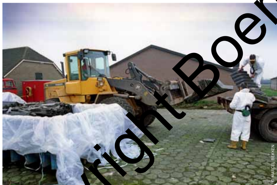
Gebruik bij het verwijderen een geschikt stofmasker en draag een wegwercoverall. Sla het asbestmateriaal op in een gesloten verpakking en breng het naar het containerpark, een vergunde stortplaats of laat het ophalen door een erkend overbrenger voor gevaarlijk afval.
