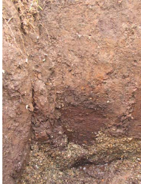
Figuur 8. Ontgraving van drain B. Deze ligt deels boven water. Rondom de drain is grit gestort.
