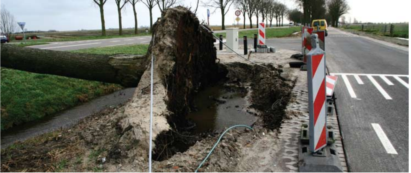
Voor het versmallen van deze ventweg is asfalt verwijderd en zijn boomwortels beschadigd, waardoor de bomen instabil zijn geworden.
