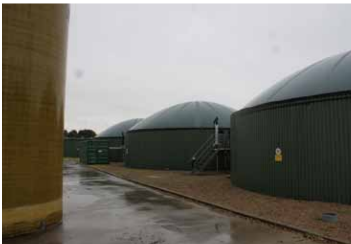
◀ Voor de productie van groen gas gaat Groot Zevert de capaciteit van de huidige biogasinstallatie vergroten van 36.000 naar 100.000 ton per jaar.
