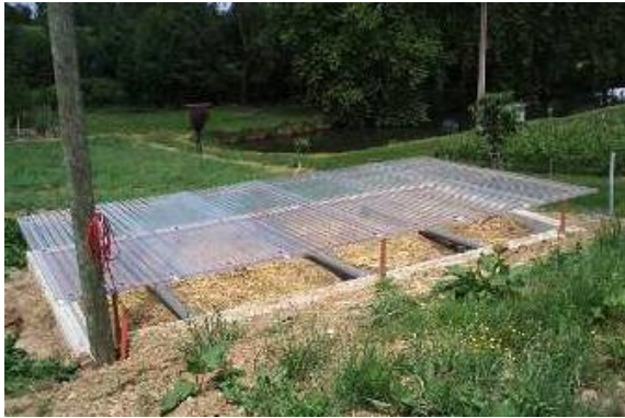
Foto 11: Voorbeeld van een Phytobac@ systeem: betonnen bak in de grond
