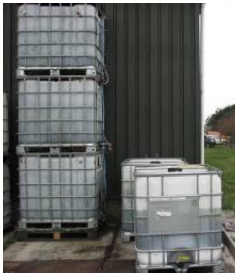
Foto 20: drie gestapelde filterunits met daarnaast een IBC met afvalwater en één voor gezuiverd water
