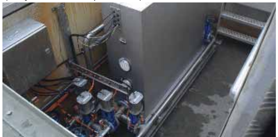
Opstelling van de ultrasone reactor bij rwzi Willem Annapolder.
