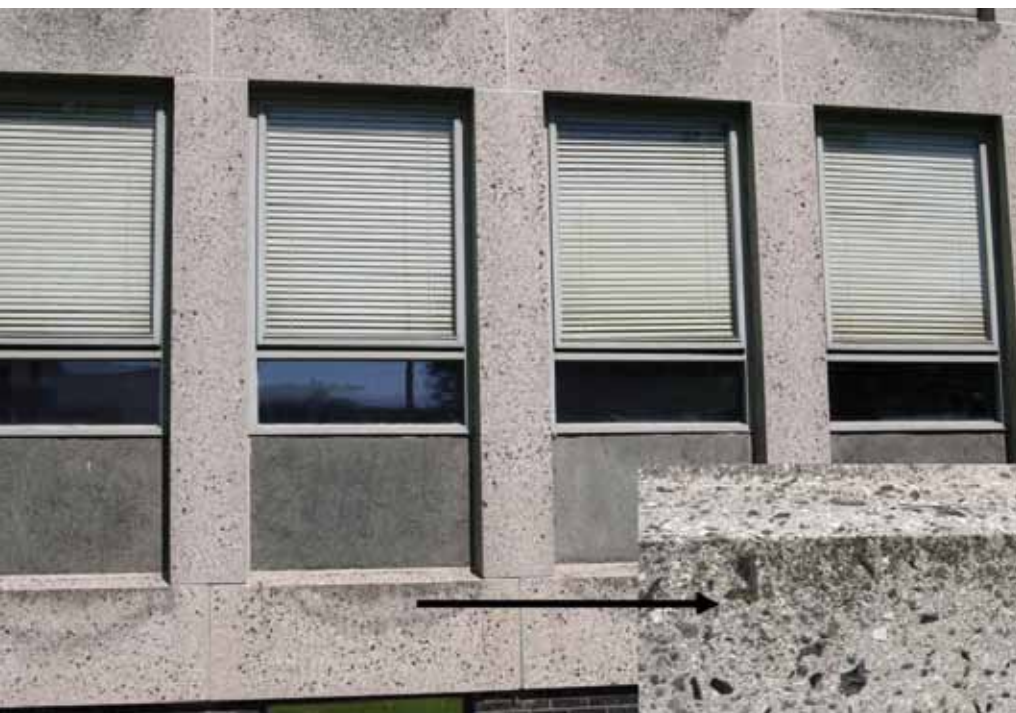
Figuur 5 Een gebouw uitgevoerd in schoonbeton. Een mooi voorbeeld van een plek waar het lokaal ontstaan van algengroei onwenselijk is, zoals is te zien op de foto. Door het beheersen van de materiaaleigenschappen zouden we dus in staat moeten zijn om dergelijke lokale vervuiling van het oppervlak uit te sluiten. Bij andere constructies zouden we dit juist kunnen stimuleren, door het oppervlak volledig te laten begroeien door bijvoorbeeld algen en mossen.
