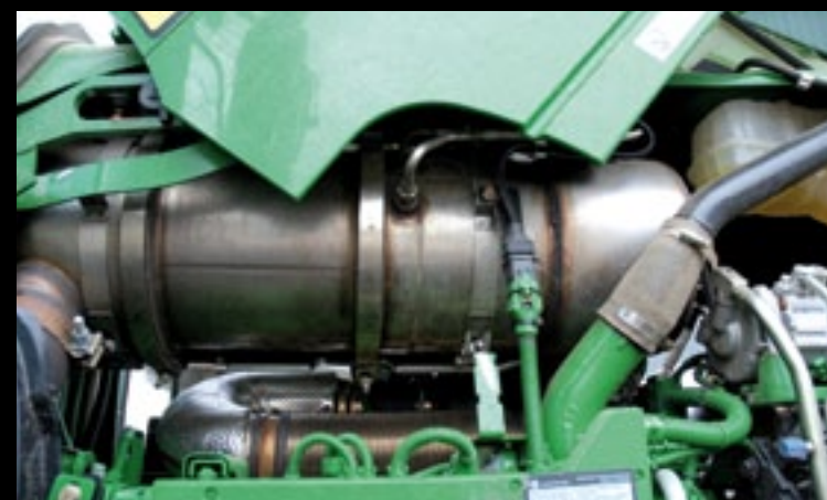
▲ In het uitlaatsysteem van deze trekker zit een katalysator – Diesel Oxidation Catalyst (DOC) en een roetfilter – Diesel Particulate Filter (DPF). In deze onderdelen zijn temperatuursensoren geplaatst. Voor een zelfreinigende werking is het belangrijk dat de juiste temperatuur wordt gehandhaafd.
