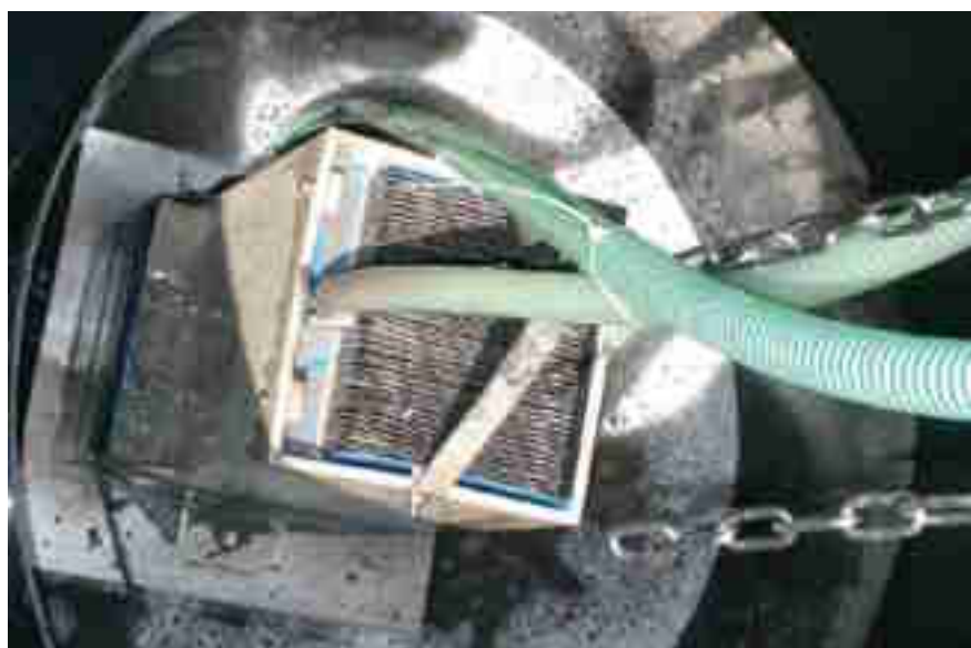
Figuur 12: Compacte zuiveringsinstallatie (membraanbioreactor) voor de zuivering van grijswater in de wijk Wohnen & Arbeiten in Freiburg, Duitsland (Foto: Erwin Koetse).
