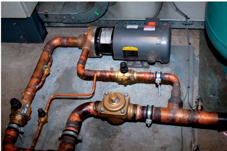
De Geerlofs-vloeistofpomp met behoud van bestaande leidingen
