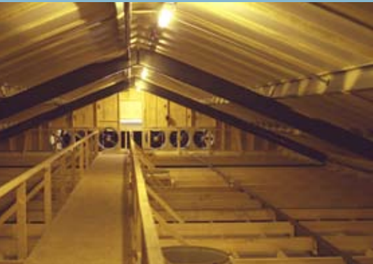
Centrale afzuiging biedt goede mogelijkheden om energie-efficiënt te ventileren. Ook warmteterugwinning uit stallucht hoort bij centrale afzuiging tot de mogelijkheden.
