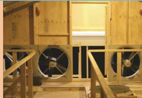
Dit centrale afzuigkanaal in een nieuwe stal is niet glad afgewerkt. Reinigen zal niet meevallen.
