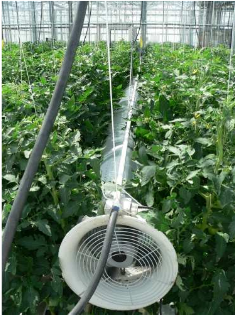
Figuur 2-2 Ventilator met luchtslang hoog tussen de koppen van het gewas.
