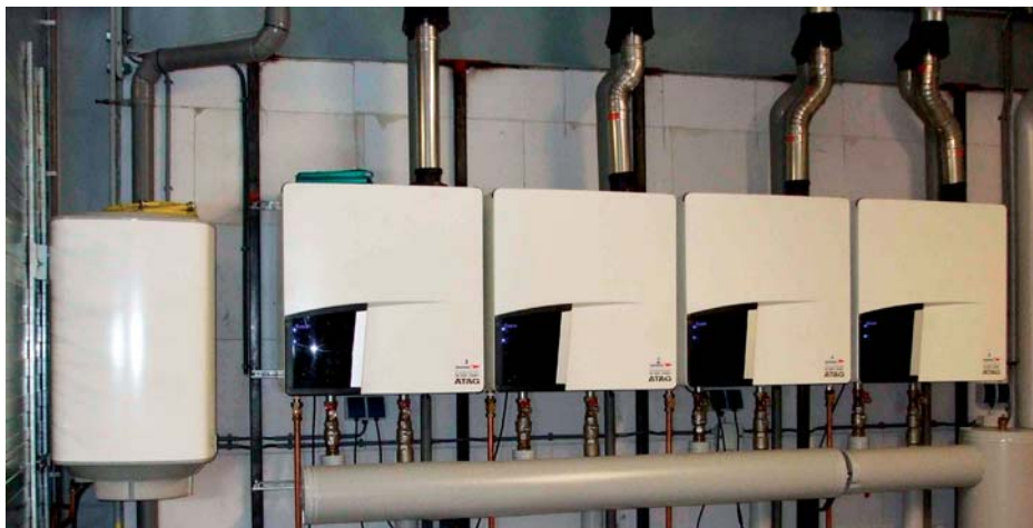
Cascadeopstelling van gesloten HR ketels
